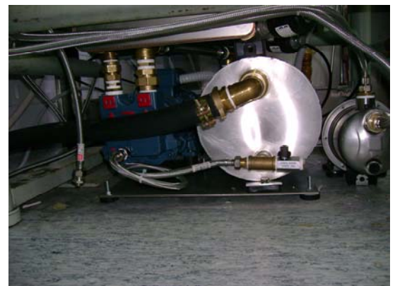
ΜΗΧΑΝΟΛΟΓΙΚΑ ΝΕΟΥ ΜΗΧΑΝΗΜΑΤΟΣ.....
